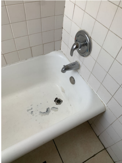
3E surface damage
